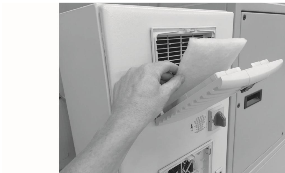
Fig. 39: Substituição do filtro no armário de distribuição
